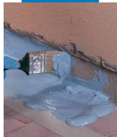
Εφαρμογή του Mapelastix® AquaDefense με βούρτσα σε αρμό μεταξύ δαπέδου-τοιχού, πριν την εφαρμογή του Mareband
