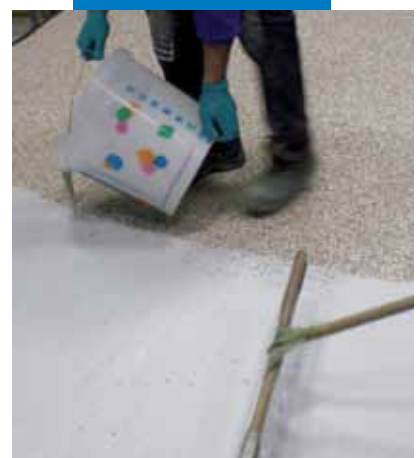
Εφαρμογή του Ultratop στη σκληρυμένη επιφάνεια του μείγματος φυσικών αδρανών + Mapefloor I 910
