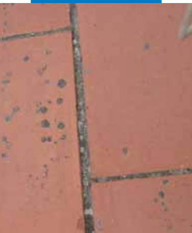
Παράδειγμα παλαιού δαπέδου με πλακίδια, που απαιτεί προεργασία πριν την εφαρμογή του Aquaflex Roof
